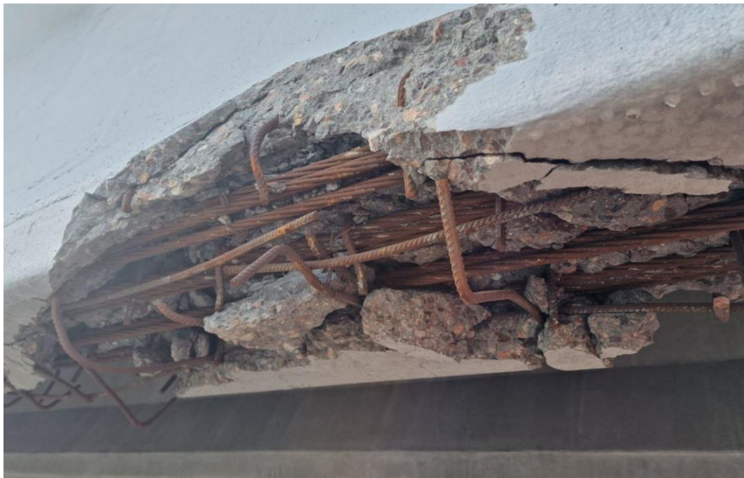
Рисунок 4. Значительные повреждения балки, повреждение рабочей арматуры Figure 4. Significant damage to the beam, damage to the working fittings
