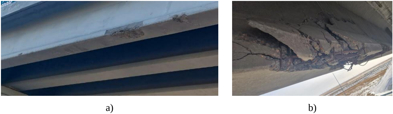
Рисунок 1. Повреждения конструкций пролетных строений: a –незначительные; b –значительные, требующие усиления;
