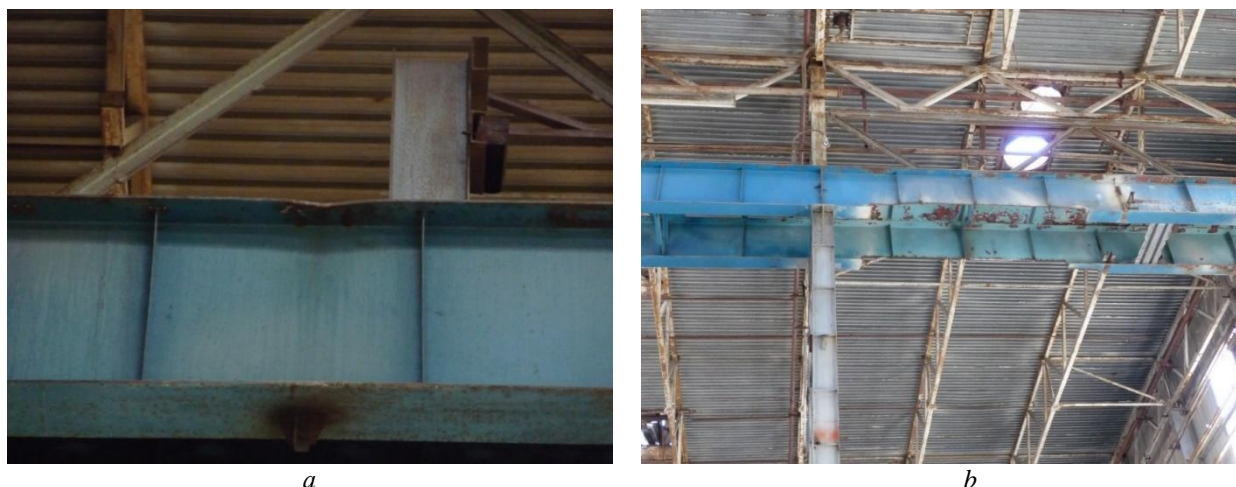
Рис. 2. Механические (а) и коррозионные (b) повреждения подкрановых балок Fig. 2. Mechanical (a) and corrosion (b) damage to crane beams
