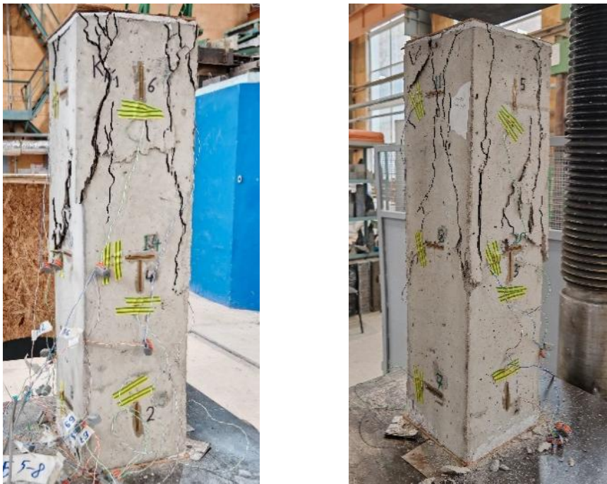
Рис. 5. Расположение трещин и разрушение колонны KK1 Fig. 5. Crack patterns and failure of the column KK1
